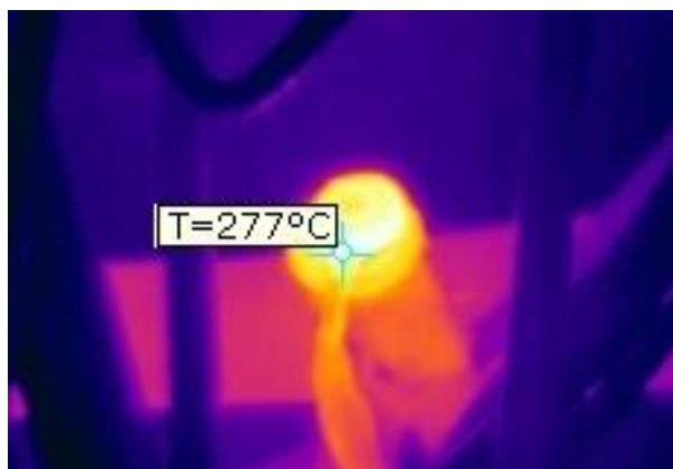
Рисунок 22. Пример обнаружения пожароопасного разогрева болтового контактного соединения
